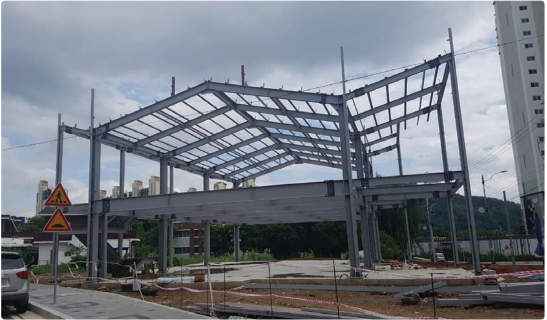
[사진1] 재해발생 현장전경
