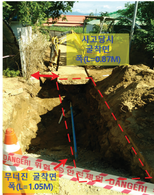
[사진1] 재해발생 현장 전경
