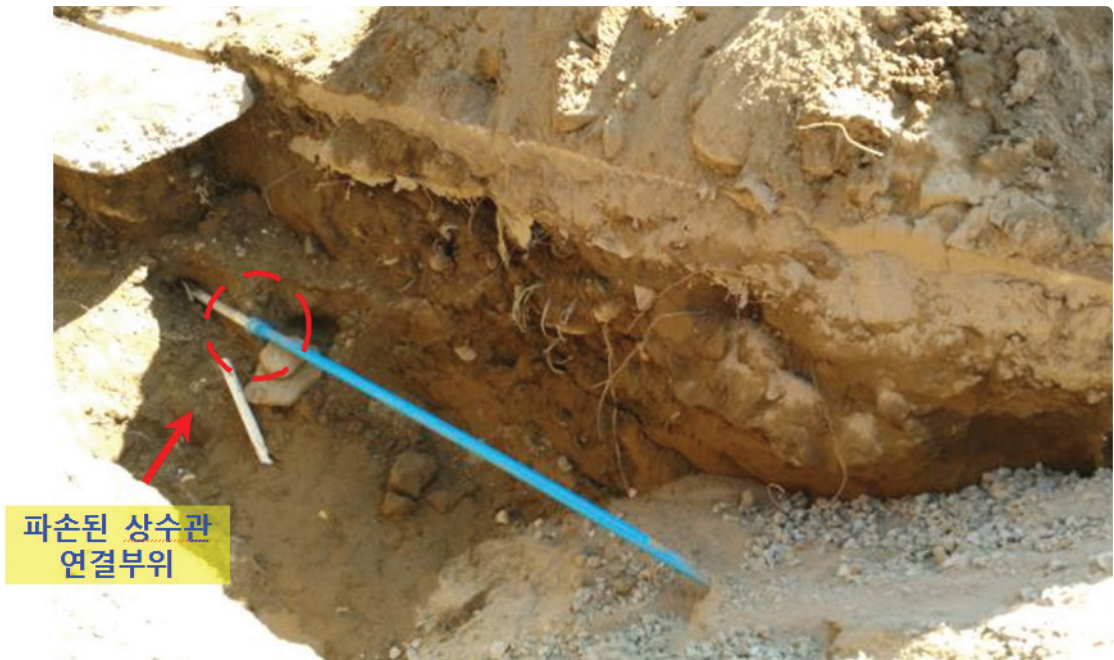
[사진2] 사고당시 무너진 굴착면 및 기존 매설된 상수관
